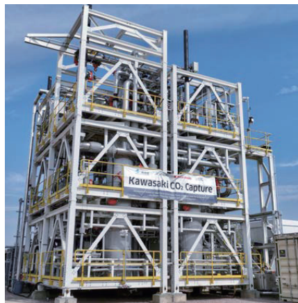
Wyoming州ITCに建設した実証設備
