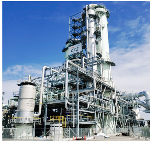
三川発電所に建設したCO 2 分離回収実証設備
